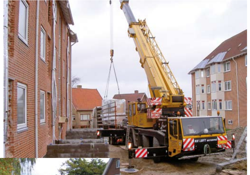
De nye badeværelser blev leveret som færdigt monterede kassetter, der blev hejst på plads ovenpå hinden med en kran og derefter tilsluttet og beklædt udvendigt med eternit.
